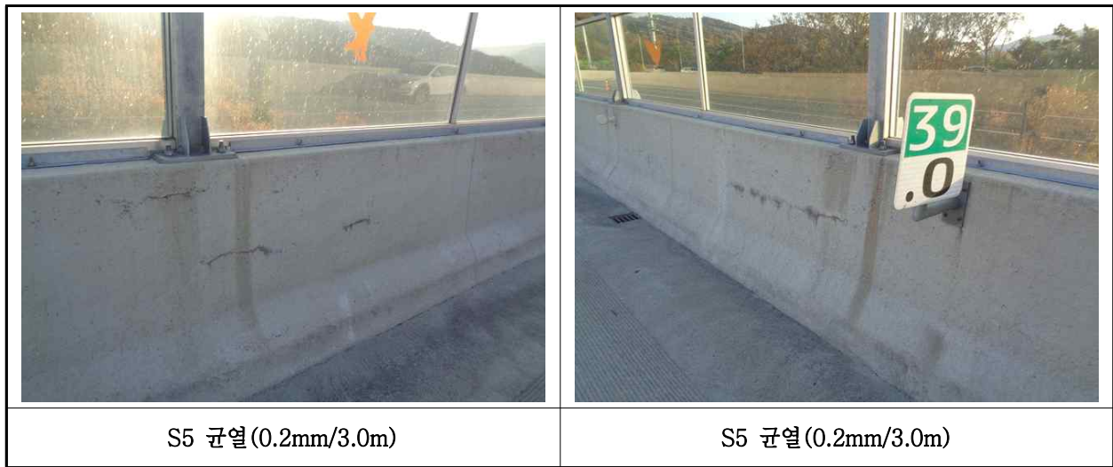
【사진 13.3.47】 방호벽 및 중앙분리대 손상현황
