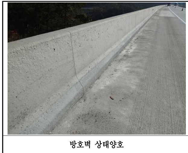
【사진 13.3.24】 방호벽 손상현황
