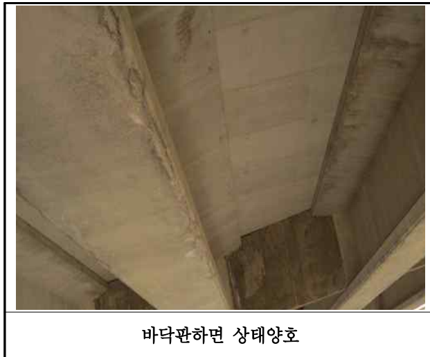
【사진 13.3.26】 바닥판하면 손상현황
